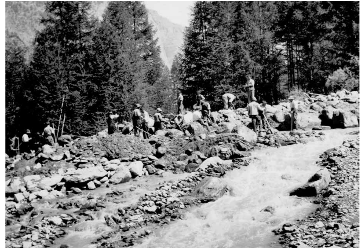
Die verheerende Katastrophe von 1947. Mit Pickel und Schaufel wird die Talstrasse nach Zermatt von Schutt und Felsbrocken befreit
